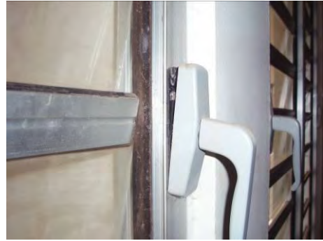
図 2 修理が困難な窓の取っ手
