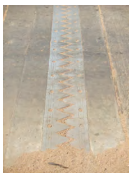
清掃不足で目詰まりしているジョイント
