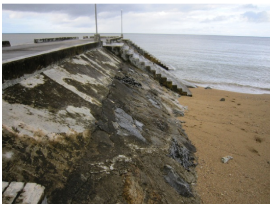
写真：修理されたコースウェイの 破損箇所（アレグリア港）
