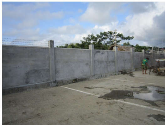
写真：修理された壁の破損箇所 （エスタンシア港）
