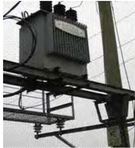
ベトナム国産の柱上変圧器
