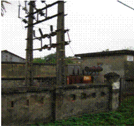
バクニン省の村にある 70 年代からの変圧施設
