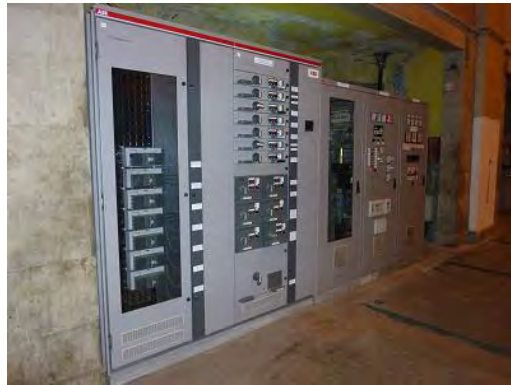
図4 更新された配電盤・機器
