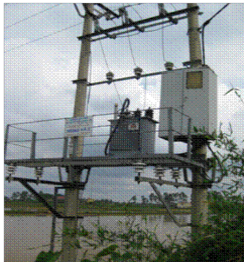
バクニン省で建設された変電施設
