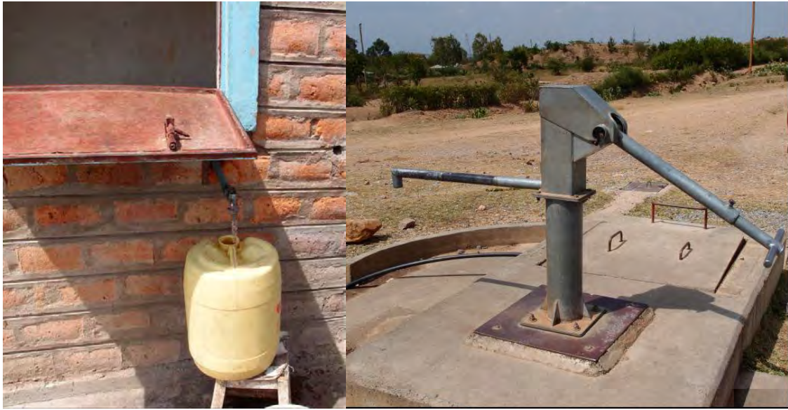
減水区間の給水施設（水道）
