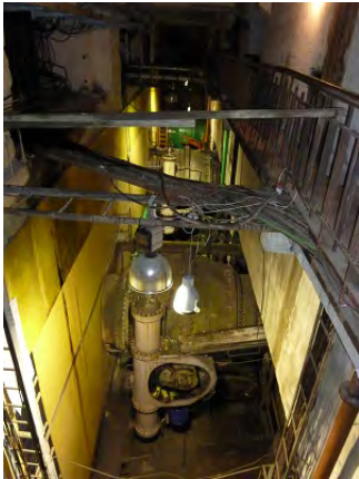
図3 3基の水管全体
