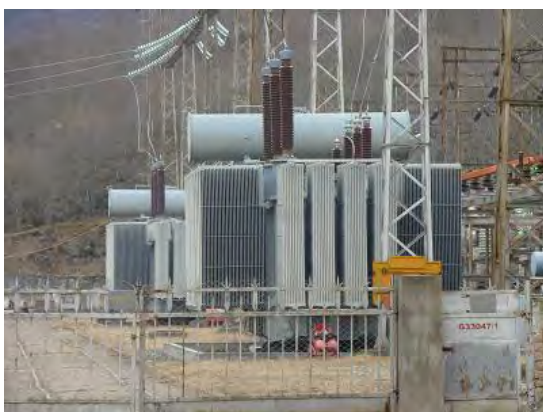
図1 更新された変圧器
