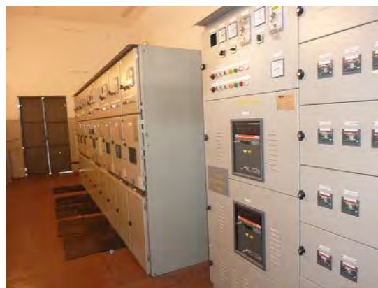
図2 更新された配電機器
