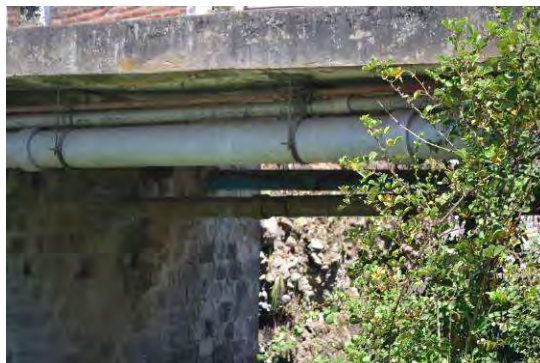
エスペランサ地区の導水管
