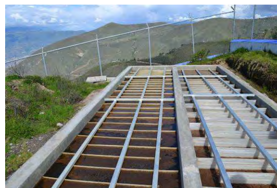
アロブロ浄水場に追加された急速濾過装置
