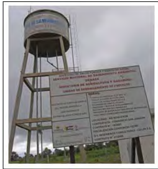
（コミュニティに設置された給水タンク）
