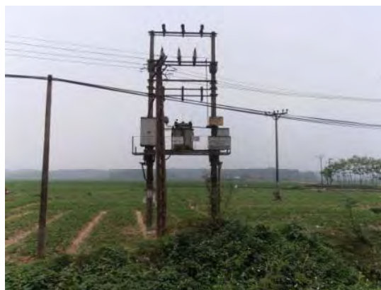
本事業で設置された配電線と変圧器
