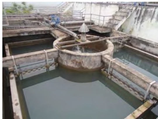
本事業で建設された浄水場のろ過池
