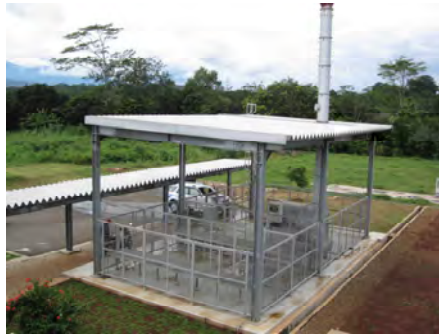
(Incinerator at the Subang DIC)
