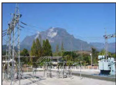
チンダオ変電所
