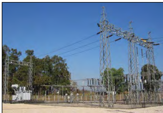
本事業で建設された変電所（ハンチャット変電所）
