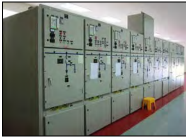
チンダオ変電所配電盤
