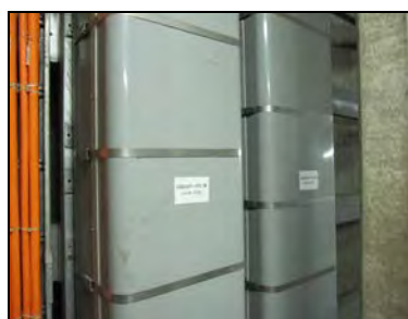
送電線トラフ
