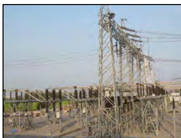
クロン克蘭変電所
