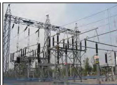
プランクラタイ変電所
