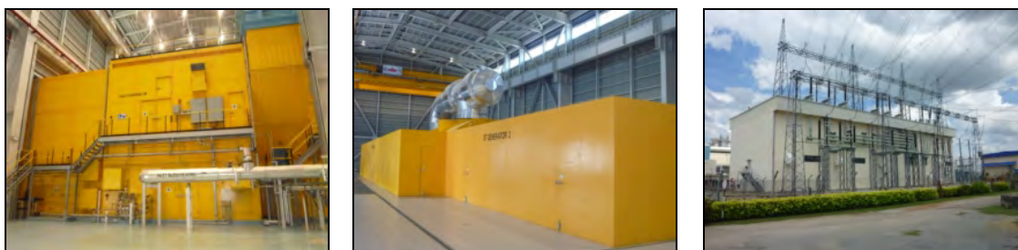
写真 2：左からガスタービン、蒸気タービンジェネレーター、送変電設備
