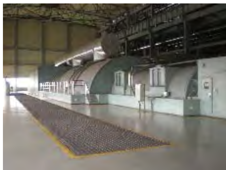
タービン発電機
