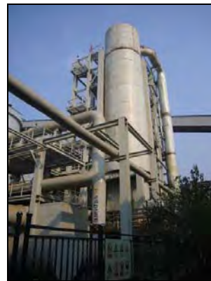
コークス炉ガス処理設備（脱硫設備）
