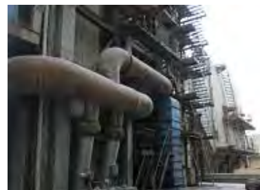
発電施設外観
