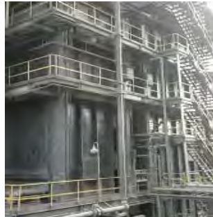
設置された脱硫装置全貌
