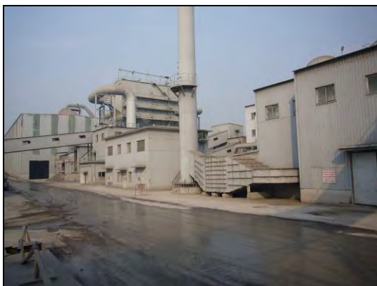
スラグ処理設備
