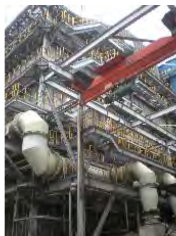
排煙脱硫装置
