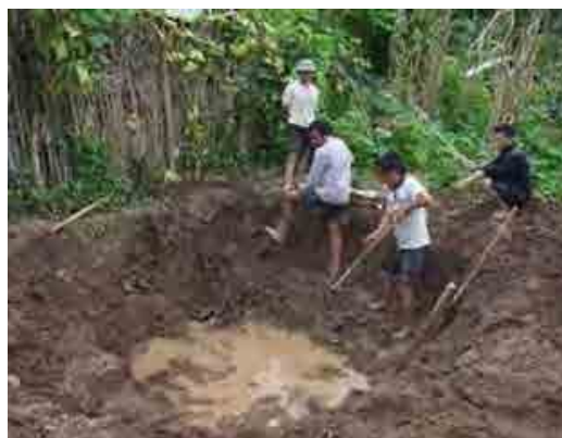
Ảnh 2-11: Chuẩn bị lắp đặt công trình khí sinh học bằng gạch ở Tia Ghénh C
