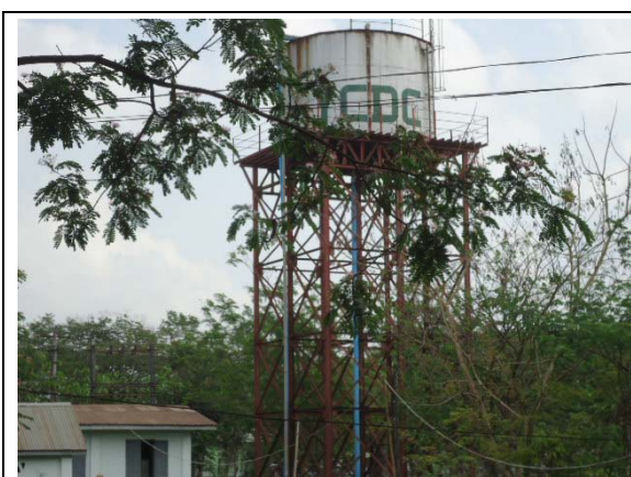
地下水を水源とする YCDC 水道施設
