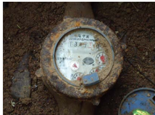
YCDC 水道の水道メータ
