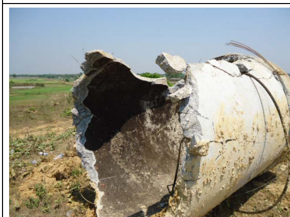
破損した配管
