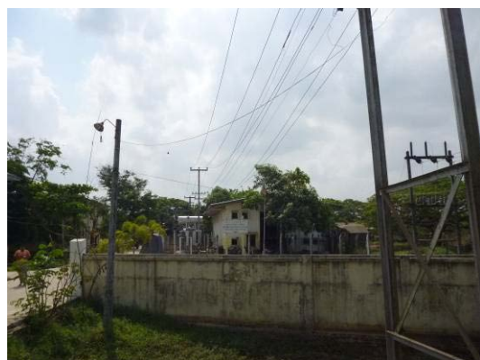
市中心部の配電用変電所（33/6.6kV）
