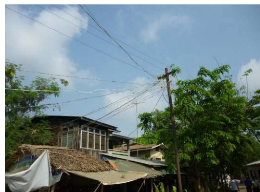
低圧配電線の分岐。 不法接続が多くみられる
