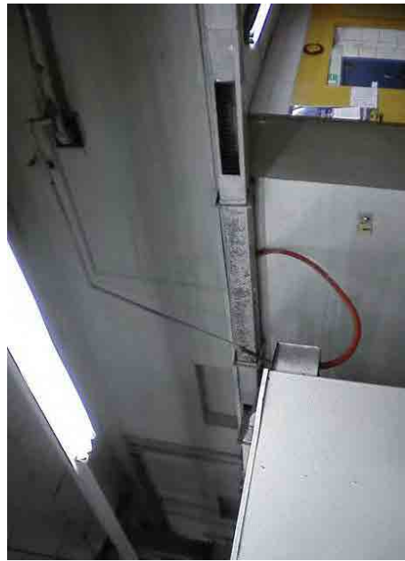
Зурагт 5-2-6: Үйлдвэрлэлийн эцсийн дамжлагын цехийн дулаан баригч хийгдээгүй хавхлага болон хоолойнууд
