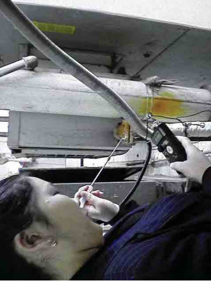
Зураг 4-1-7: Уурын трапын хэмжилт үзлэгээр сонсож оношлогчийг ажиллуулж үзэж буй байдал
