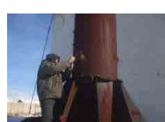
Төмөр зам ПДМС 鉄道修理場
