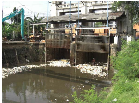
Salah satu pintu pengendali banjir di Kota Jakarta.
