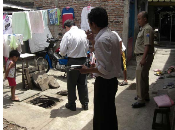
Kondisi septic tank di daerah permukiman kumuh.
