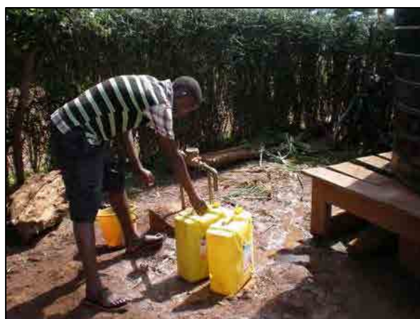
個人宅に設置された給水栓。メーターにより使用水量が管理されている。
