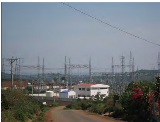
Photo 1: Di Linh Substation
