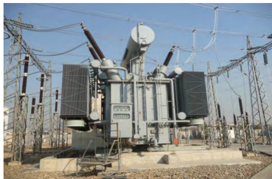
イスラマバード大学変電所の屋外トランス
