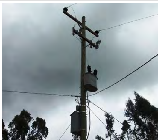
農村の電柱と変圧器（カハマルカ州）
