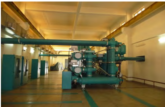
イスラマバード大学変電所のブスバー
