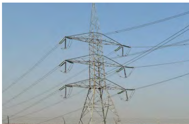
送電鉄塔（レワット～イスラマバード送電線）
