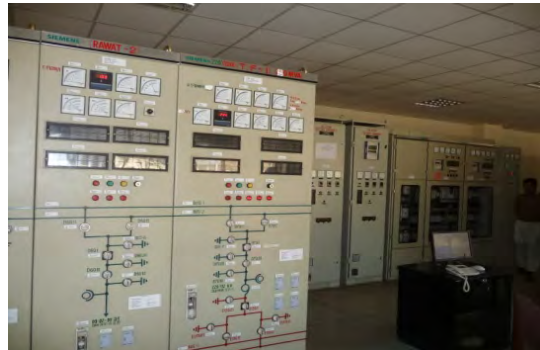
イスラマバード大学変電所の制御室
