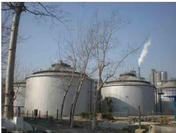
図 13 汚泥消化槽 32 （紀庄子污水处理場）
