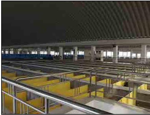
図 4 上水道拡張事業 浄水場内部
