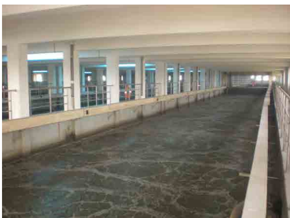
図2 生物反応池（杭州市汚水処理場）
