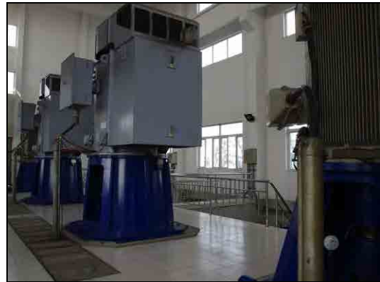
図 7 取水ポンプ場
