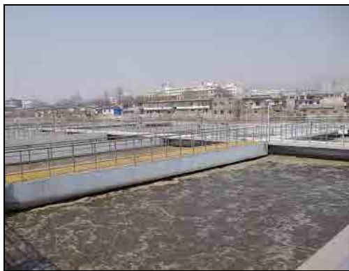
図 2 汚水処理場の生物処理池
