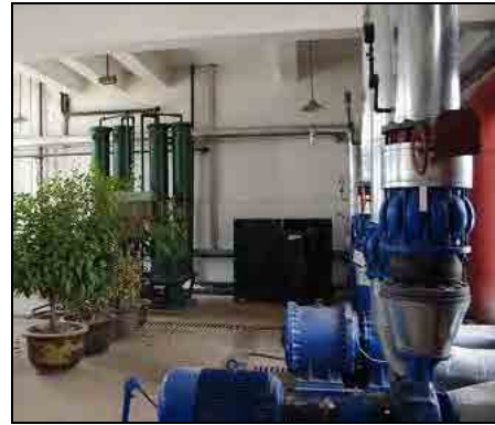
図 5 熱供給事業 集中熱供給施設
