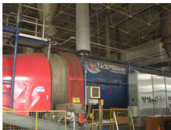
図 14 汚泥乾燥機（咸陽路污水处理場）
