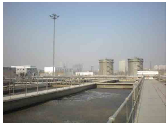
図 3 咸陽路汚水処理場反応池
