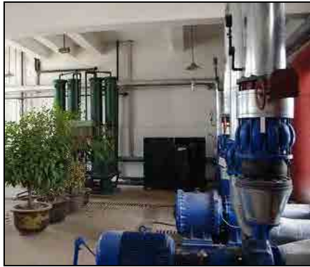
図 6 市内の熱交換所内部
