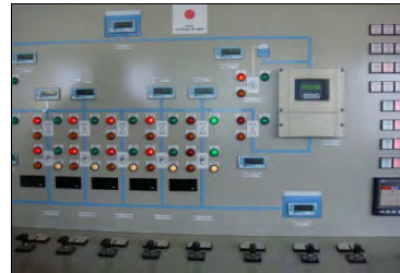
上流水源遠隔操作設備
