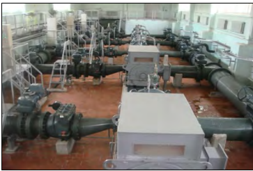
上流水源送水ポンプ
