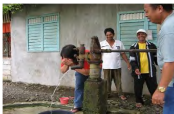
図 5 設置された給水システム
