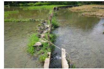
図 4 一部破損してしまった用水路
