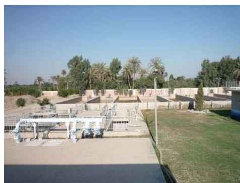
排水池・スラッジ処理施設
