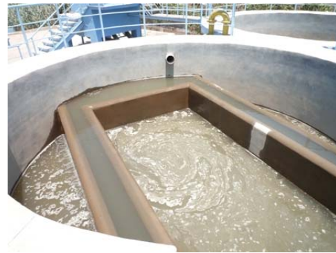
改修済簡易浄水施設（フロック形成・薬品沈殿池）
