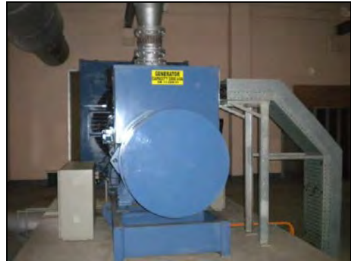
本事業で調達された発電機
