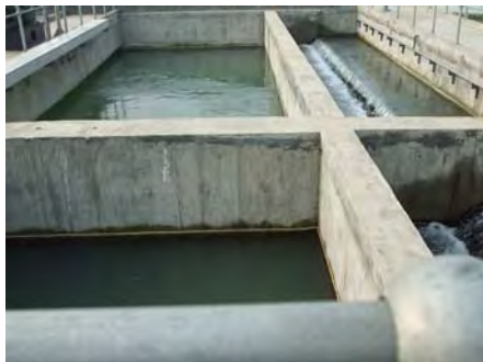
浄水施設（プラントC）
