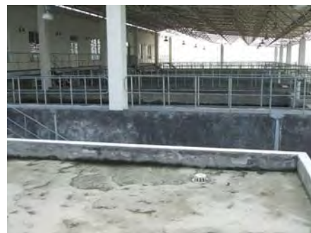
浄水施設（プラントC）
