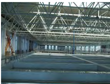
瓦房店浄水場
