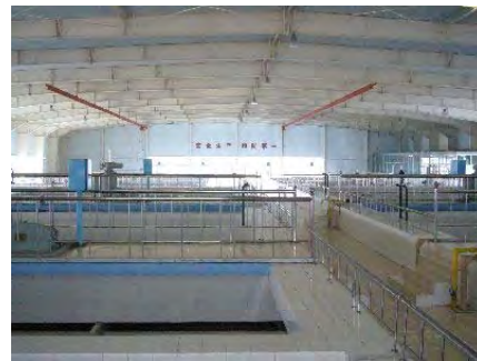
煙台経済技術開発区第2浄水場
