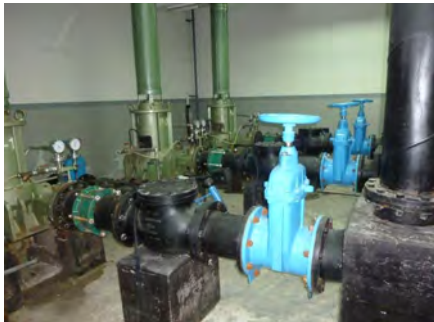
図6 中継（増圧）ポンプ場施設 （サヌール地区）
