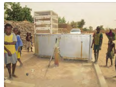
手押しポンプに付設された除鉄装置 (モプチ州 Woroyesso 村)
