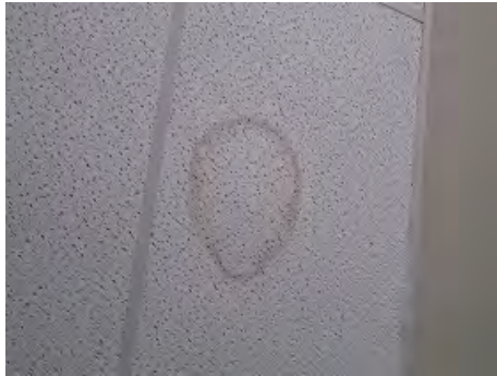
天井の雨漏り
