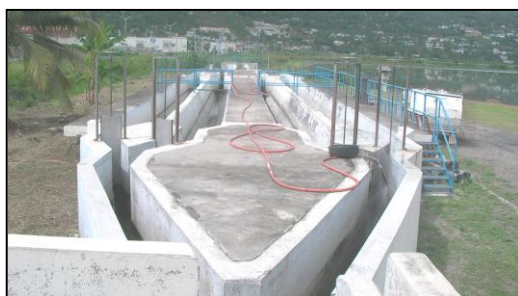
写真-1 処理施設の状況(下水流入口)
