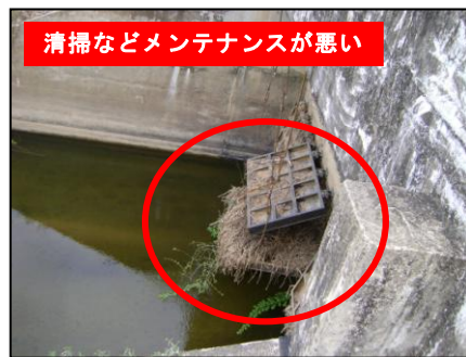
写真-2 フラップゲートの様子
