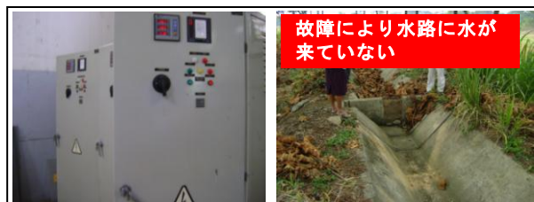
写真-1 配電盤(故障)と3次水路の様子
