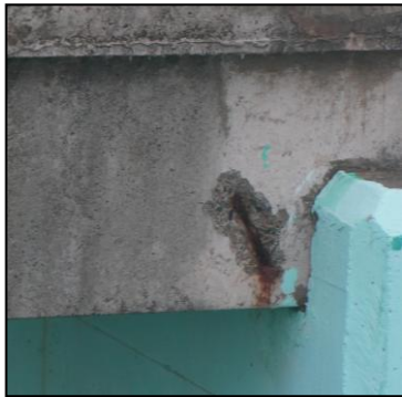
写真-19 コンクリート剥離箇所
