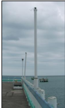
写真-20 電灯の破損
