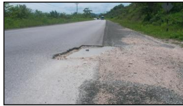
写真-8 道路破損の状況 (路肩の破損状況)
