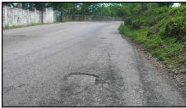
写真-7 道路破損の状況 (ポットホール)
