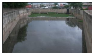
洪水排水施設
